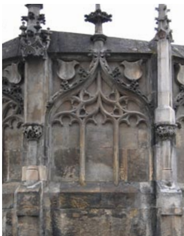
Stav před restaurováním
