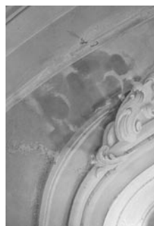
Poškození intonaka zatékáním.
