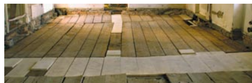
Ruby prken stropu 2.23 v místnosti č. 3.23 po konzervaci a doplnění novým dřevem
