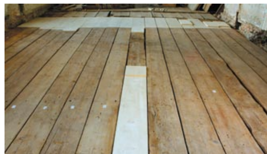
Ruby prken stropu 2.23 v místnosti č. 3.23 po konzervaci a doplnění novým dřevem
