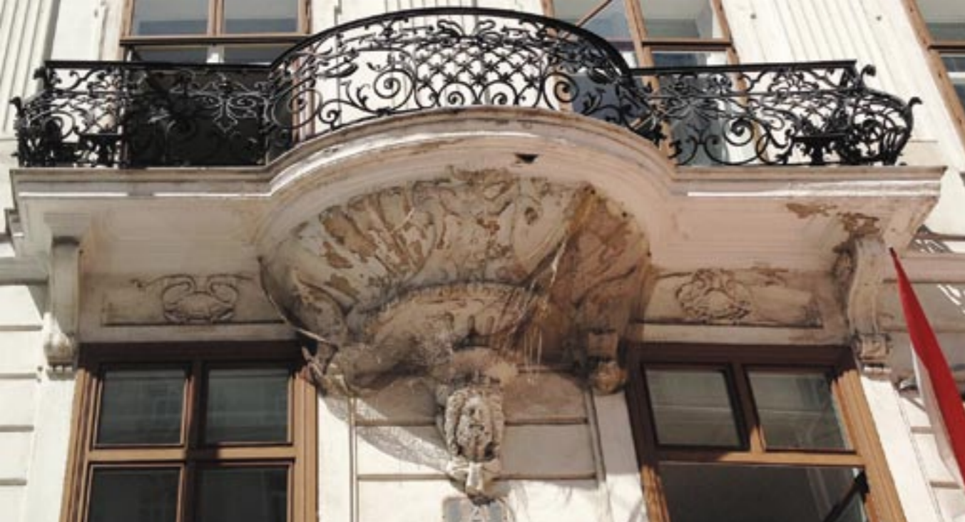
Obr. 6. Balkon Neuer Markt 14, výchozí stav. Foto Mag. Christian Gurtner.
