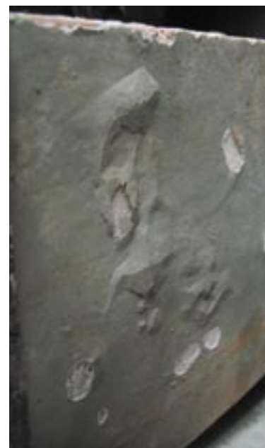
Obr. 2 Pozvednutá glazura i engoba v důsledku objemových změn vlivem vlhkostní roztažnosti.
